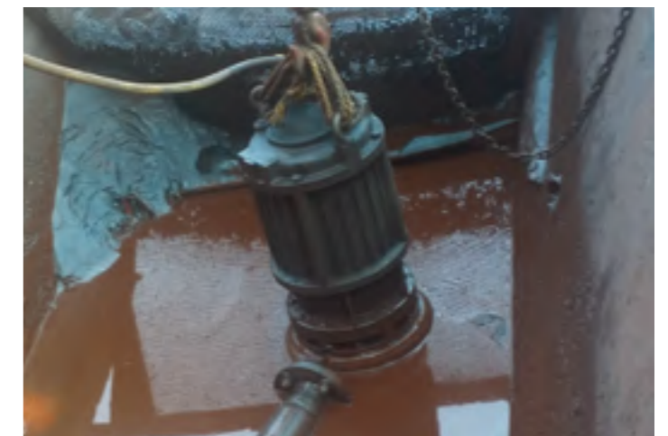
Транспортировка технической воды
